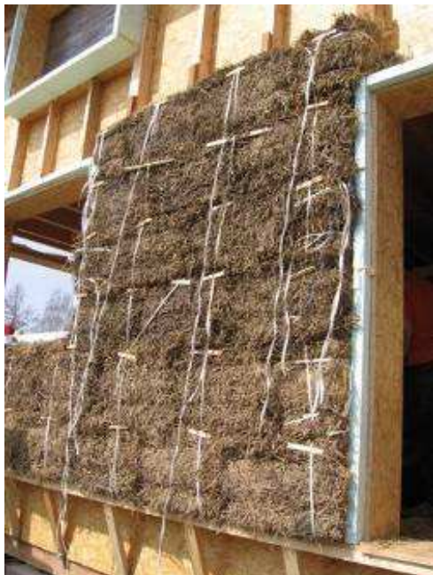
Obr. 31 – Představená stěna z balíků, které jsou ke sloupkům upevňovány provázky. Povrch balíků se následně opatří hliněnou omítkou.
